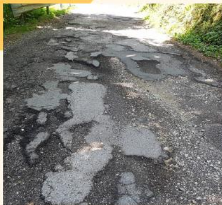
STRADA DISSESTATA E DEGRADATA
